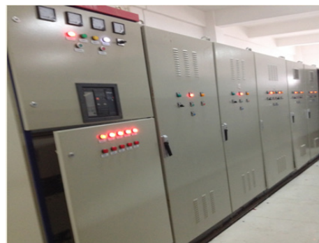
燃气锅炉控制柜
